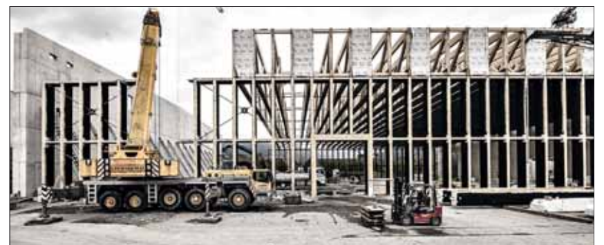
Die 70 m breite, 170 m lange und 5,5 m hohe Messehalle von Dornbirn wurde als Holztragwerk aus 1,80 m hohen Fachwerkträgern auf eingespannten Brettschicht-holz-Stützen ausgeführt. 65 Stück davon haben die Planer in engem Abstand zu einem imposanten Dachtragwerk gereiht.
